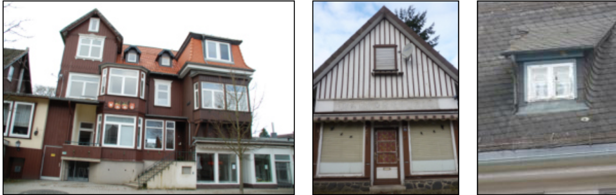
Abb. 25, 26 und 27: Gebäude oder Gebäudeteile mit hohem Sanierungsbedarf
