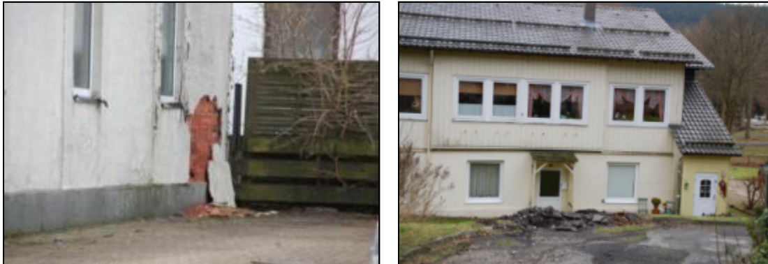
Abb. 46 und 47: Beispiele für Sanierungsbedarfe, die dem Besucher „ins Auge fallen“
