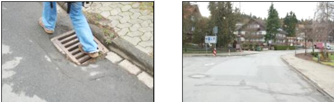
Abb. 60 und 61: Schäden im öffentlichen Raum
